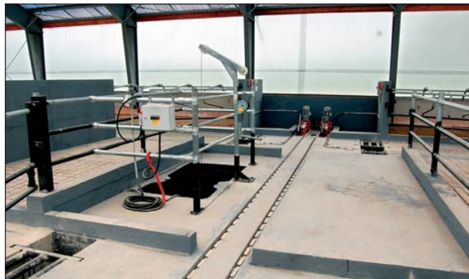
Stredová chodba s preronovým kanálom (vľavo vpredu), v ktorom je uložené pretlakové čerpadlo (vľavo v strede). V zadnej časti snímky je pohon reťazových zhŕňáčov exkrementov.
